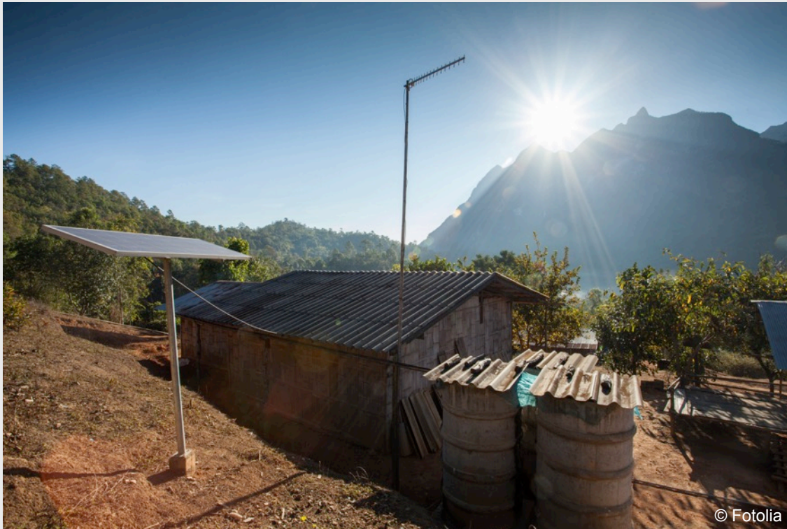
Panneaux solaires, zone rurale PED
