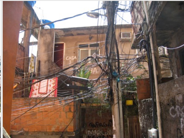
Raccordements électriques dans une favela, Brésil
